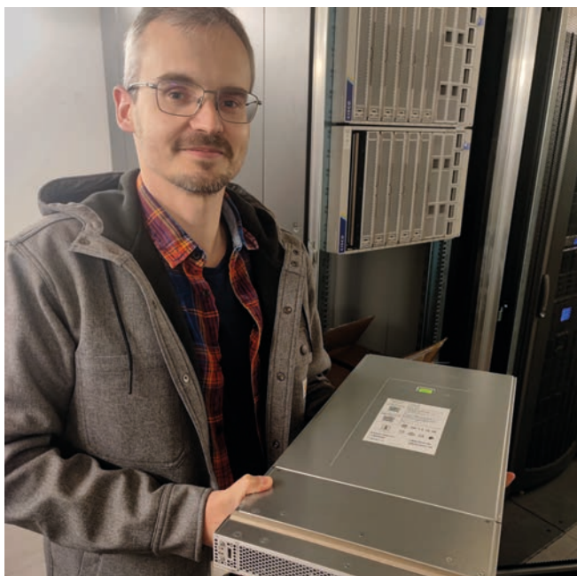
Bereichsleiter Stefan Schulz aus der IT zeigt eine der vielen, vielen neuen Blade Server, auf denen unsere Daten nun sicher liegen.
